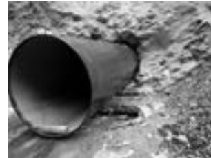
Kayaköprü 1 HES Sürme Boru
