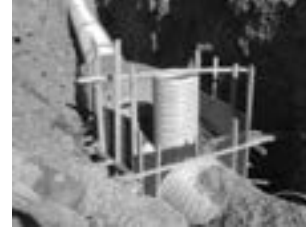
Kaletepe HES İletim Hattı U-PVC Boru, 11.500 m
