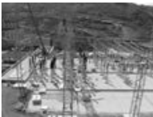
Devecikonağı HES Şalt Sahası 154 kV
